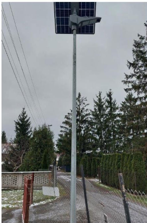
Sołectwo Kawęczyn - oświetlenie solarne uliczne
